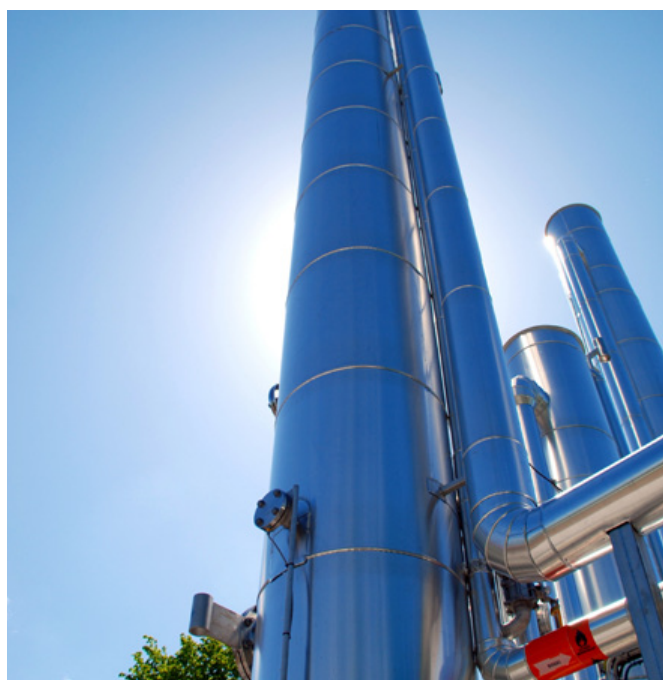
Impianto di upgrading a Källby, Svezia. Foto: Mårten Ahlm
