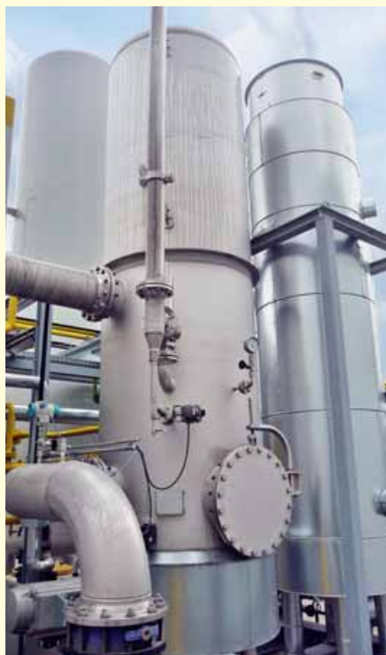
Foto A Le torrette di lavaggio dell'impianto di purificazione
