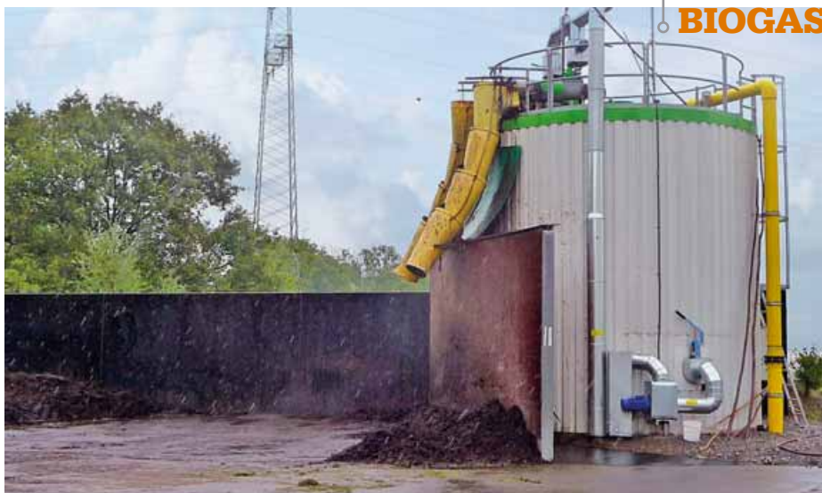
Foto 3 L'impianto di separazione solido-liquido
