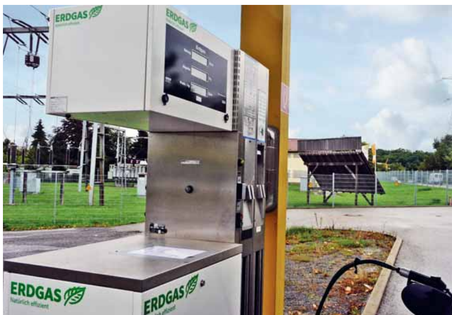
Foto 2 La stazione di rifornimento che distribuisce anche il biometano prodotto dall'impianto
